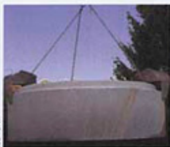
Gefährliches Setzen eines Schachtes mittels kraftschlüssiger Lastaufnahmemittel.
